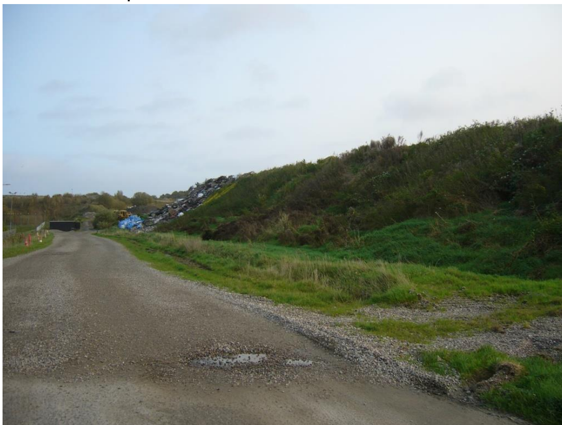
Figur 2: Sydskråningen på etape A, hvor perkolatudsivningen i 2016 skete. I forgrunden ses den oprensede grøft, og i baggrunden den igangværende celle for asbest/eternit (som ikke indgår i recirkuleringen).
